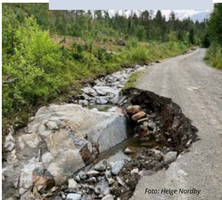
FIGUR 24 Skader etter ekstremværet Hans
