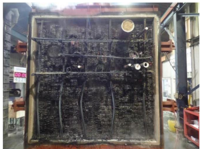
Brannutsatt side av massiv tre element (3m x 3m) branntettet med Protecta produkter
